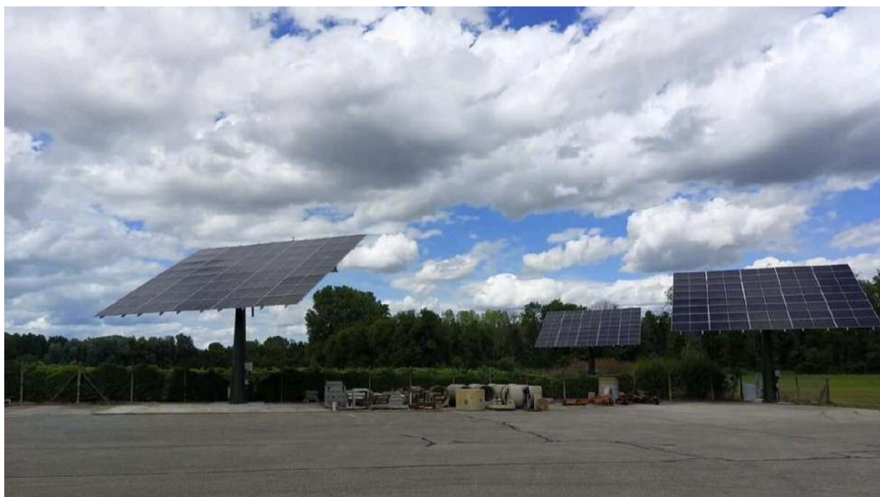
Les trackers photovoltaïques installés sur la commune de Chavannes
